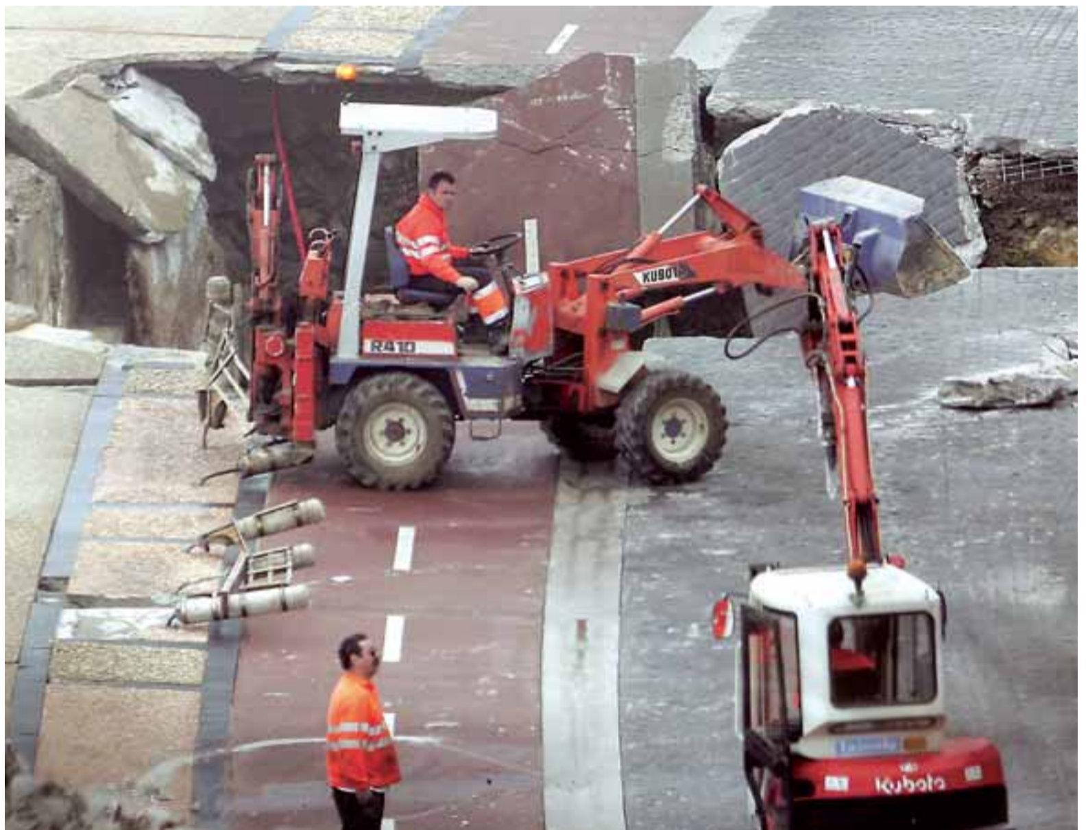
Tres trabajadores junto al enorme socavón que el temporal provocó en el Paseo Nuevo donostiarra. FOTO: IKER AZURMENDI
